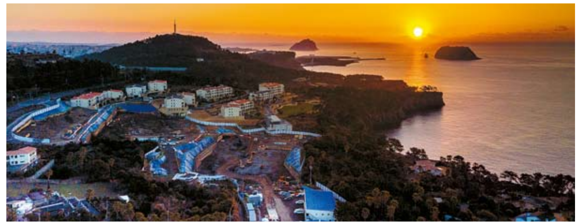
제주 JW 메리어트 리조트 우리 현장은 아름다운 자연경관을 가진 제주도의 한라산 남단 서귀포시 해안가에 위치하고 있습니다. 2018년 8월 착공한 현장은 2019년 3월에 1단계(토목) 공사를 마무리하기 위해 전 직원이 힘을 합쳐 최선을 다하고 있습니다. 떠오르는 해돋이를 바라보며 오는 3월에 발주 예정인 2단계 건축공사도 꼭 우리 회사가 떠맡 수 있길 기원합니다. 고지훈 사원
